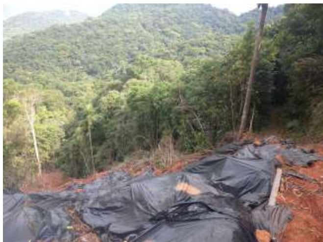
Figura 3: Local do escorregamento e a dificuldade de acesso
