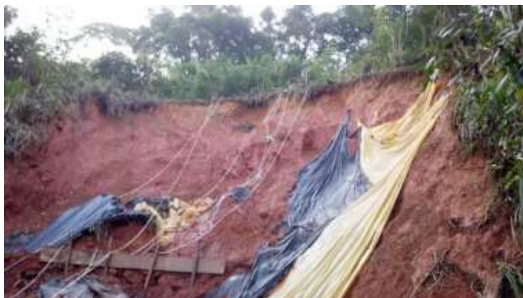
Figura 2: Vista da crista da ruptura.
