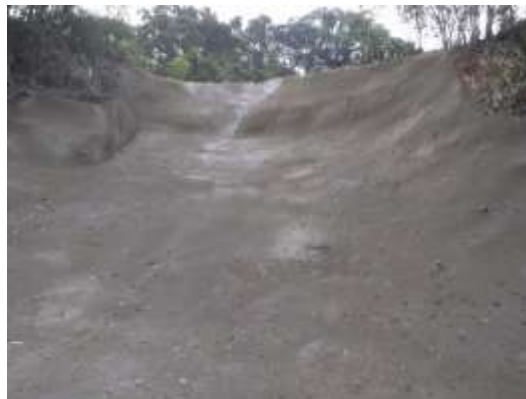
Figura 9: Paramento de concreto projetado no trecho rompido.
