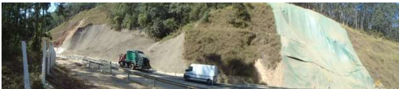
Foto 1: Taludes de corte rompidos em beira de estrada
