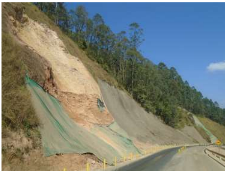
Foto 2: Talude rompido já com a estrada de acesso liberada
