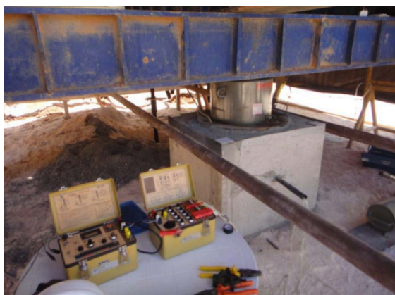
Figura 7. Unidade de leitura da instrumentação. Fonte: Engeobase (2013)
