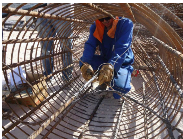
Figura 8. Barra instrumentada no eixo do tubulão. Fonte: Engeobase (2013)
